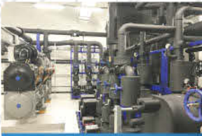
Холодоснабжение Chilled water
